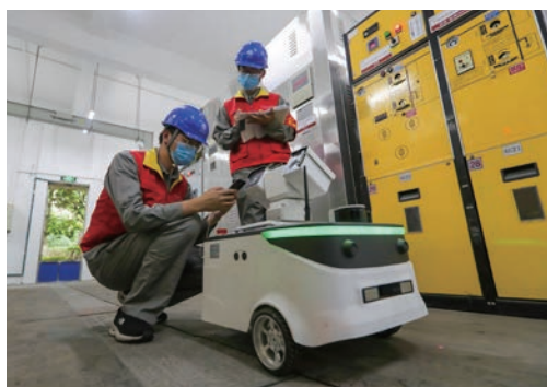
我市各地多措并举应对台风“梅花”。图为鹿城供电分局通过投用巡检机器人开展智能巡检，保障台风来临电力安全稳定供应（刘伟 林婷玮/摄）
